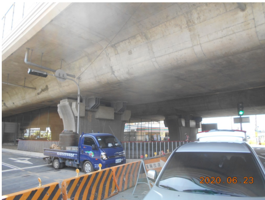
圖 2.6-3、國道四號橋下國豐一路道路封閉現場照片
