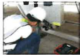
支撐架、 螺絲、IN- VERTER 巡檢維修
