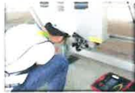
支撐架、 螺絲、IN- VERTER 巡檢維修
