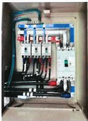
加裝電驛保護開關， 短路時自動跳脫。
