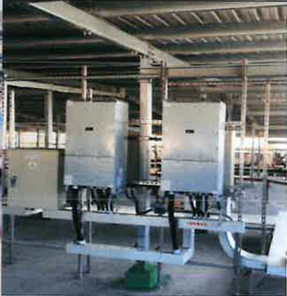
機電設備區安裝於光電板下方 參考照片如下：
