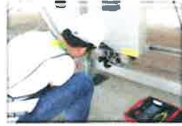
支撐架、 螺絲、IN- VERTER 巡檢維修
