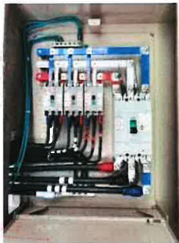
加裝電驛保護開關， 短路時自動跳脫。
