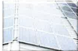
面板破裂 維修更換
