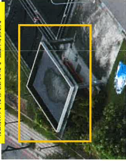
加氯消毒及放流水監測機房
