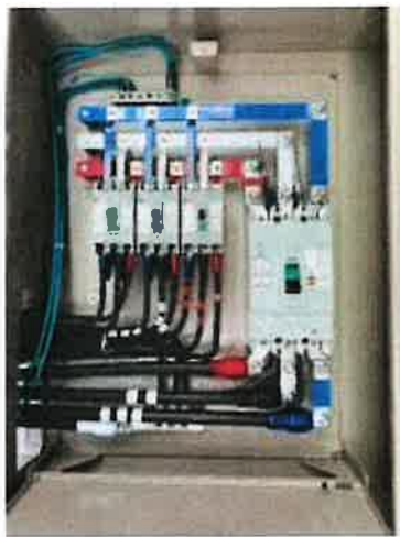
加裝電驛保護開關， 短路時自動跳脫。
