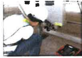
支撐架、 螺絲、IN- VERTER 巡檢維修
