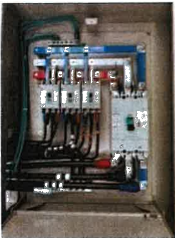
加裝電驛保護開關， 短路時自動跳脫。
