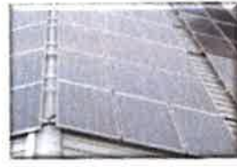
面板破裂 維修更換
