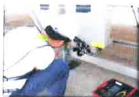
支撐架、 螺絲、IN- VERTER 巡檢維修
