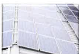
面板破裂 維修更換
