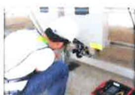
支撐架、 螺絲、IN- VERTER 巡檢維修
